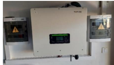
Slika 6 – Slika solarne elektrane
