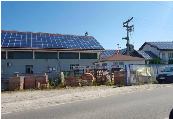
Slika 2 a) Izgled solarne elektrane
