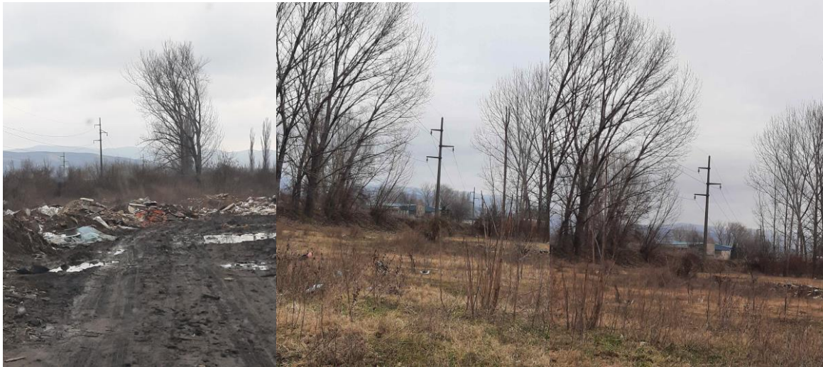
Slika 1. Primeri ugrožavanja dalekovoda 35 kV od strane visokih stabala lociranih van trase
